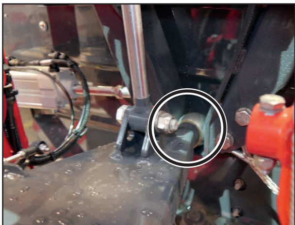
Kalde kompensator/pendellukk lukustatud
